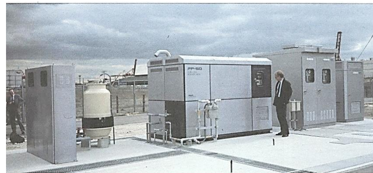
Εικόνα 4. Μονάδα κυψέλης καυσίμου φωσφορικού οξέος 50 kW, της Σουηδικής εταιρείας Wattenfall AB (0.1-100 MW τροφοδοσία καύσης RDF).
